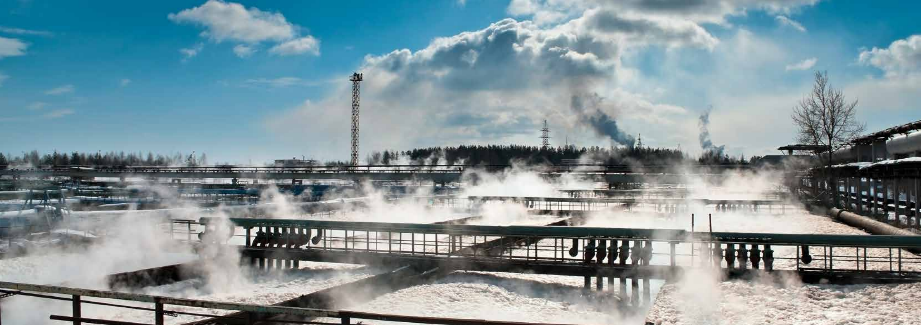
Traitement des eaux usées dans une station biologique.
